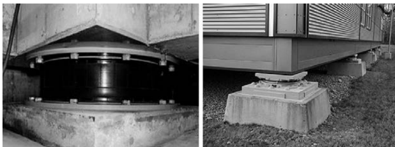
Рис. 13.2. Общий вид резинометаллических опор
